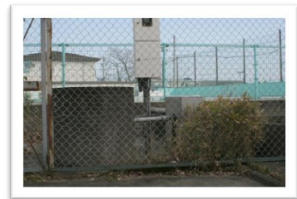
幸小学校にある揚水ポンプ
